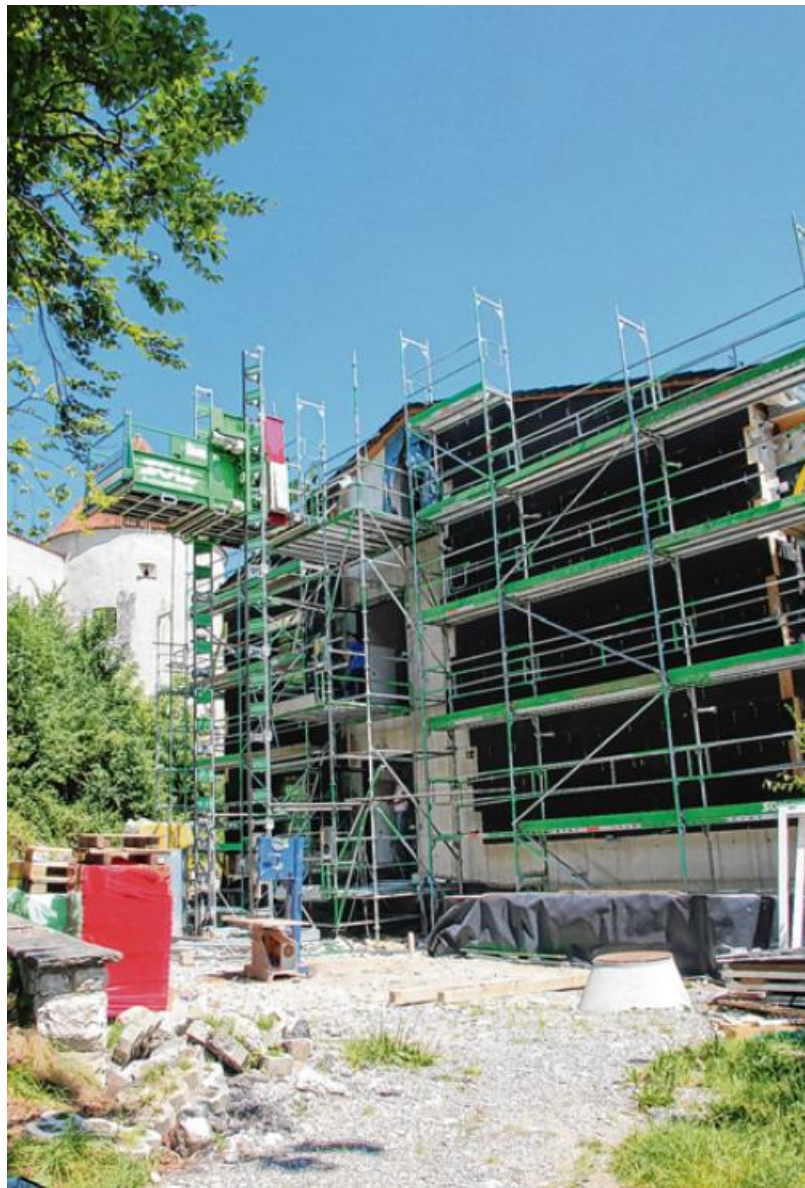
In diesem Bereich des Gebäudedetails ist die schwarze Dämmschicht bereits größtenteils angebracht, die Fassade folgt in den nächsten Wochen. Foto: Dominik Riedle
